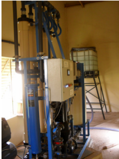
Unité MF/UF (capacité : 10,000L/hr – modèle AX2) installée à la station de traitement d'eau d'EDM-SA de Bamako
